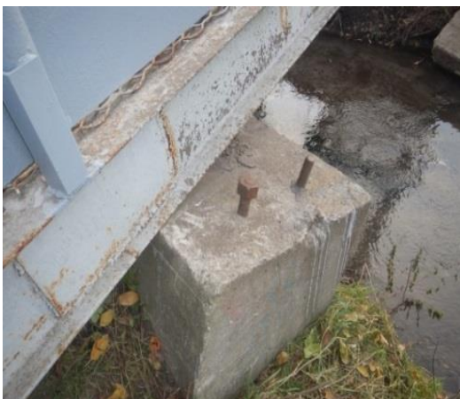
Рис. 5. Корозія поверхні металевих конструкцій
