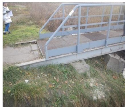
Рис. 8. Розмиття ґрунту підходів до мосту через відсутність організованого водовідведення та належного покриття
