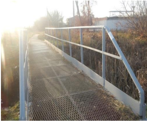
Рис. 3. Деформація, недостатня жорсткість листа покриття мосту
